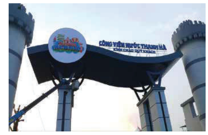
09. Chữ nhôm mặt mica in Uv kết hợp chữ nhôm uốn nổi cắm led đúc quanh viền Công Viên Nước Thanh Hà.
